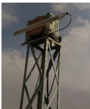
شکل ۹. نمای کلی آنتن ساخته شده و نحوه نصب آن در آزمایشگاه آنتن تکتا (از دو جهت متفاوت)
